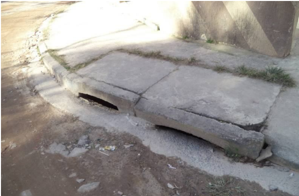
Boca de lobo dupla próxima a estaca 18.
