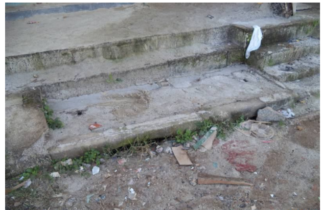
Boca de lobo dupla próxima a estaca 10.
