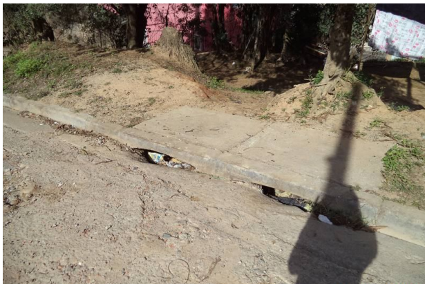
Boca de lobo dupla próxima a estaca 9.
