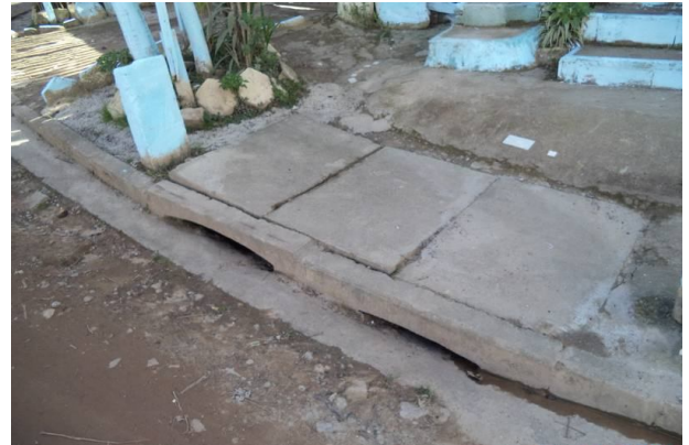
Boca de lobo dupla próxima a estaca 19.
