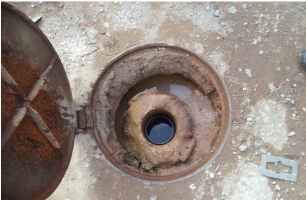
Poço de Visita deteriorado.
