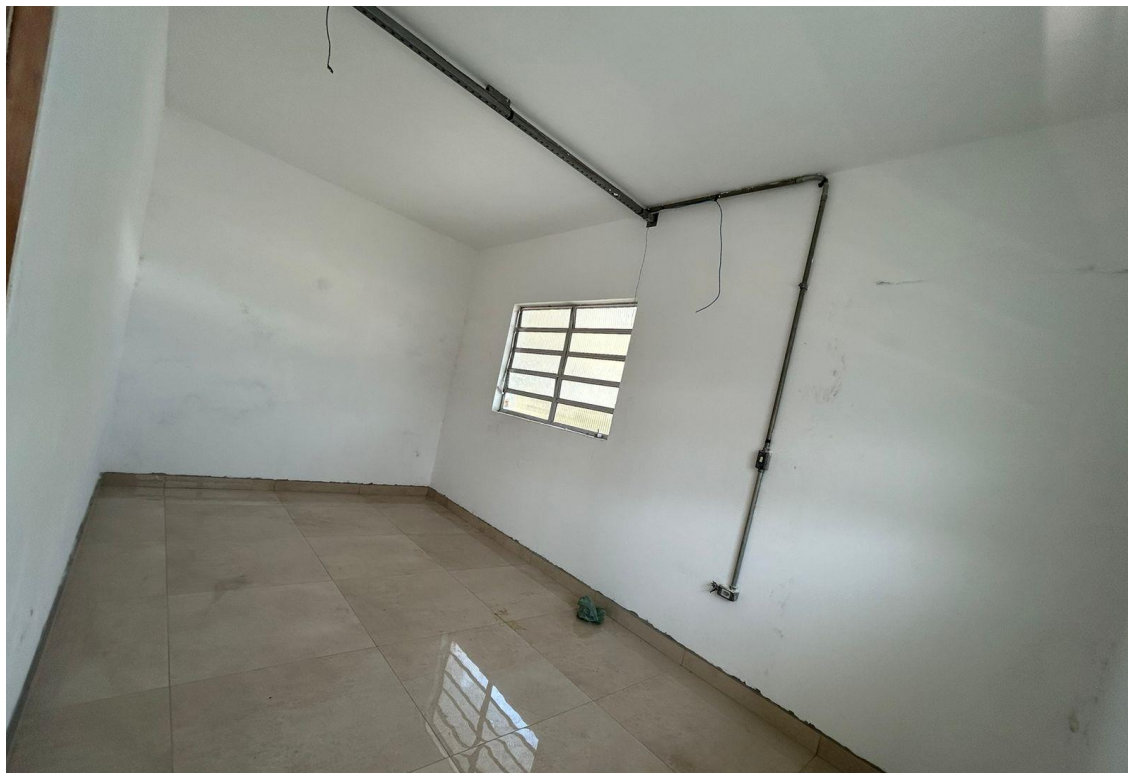
Prédio Superintendência - Sala da Diretoria de Assuntos Jurídicos.
