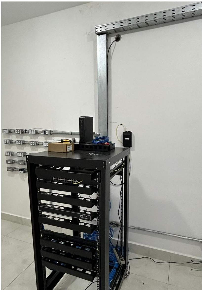
Prédio Administrativo - Interior da sala de equipamentos, donde deverá partir o cabo de fibra ótica.
