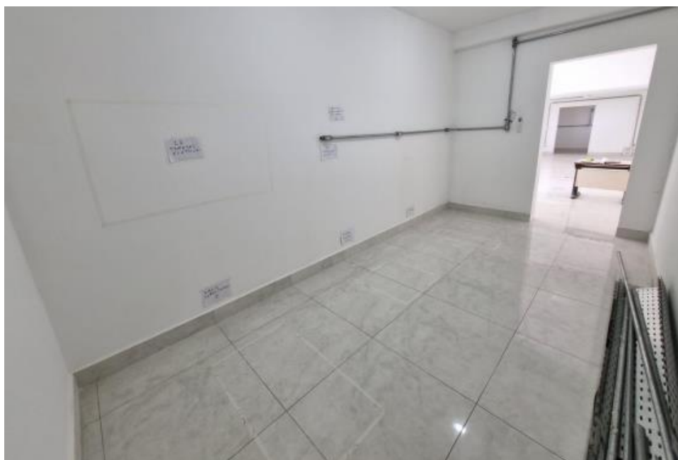
Sala de Datacenter, vista a partir do fundo da sala para a porta.
