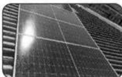
Placas fotovoltaicas no AME-PG
